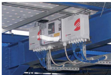
Quadro di parallelo stringhe: smart string box del tipo CS-SP(A)-16-600V
