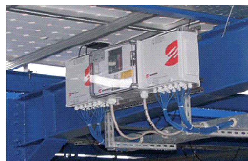
QUADRO DI PARALLELO STRINGHE
